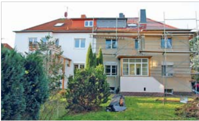
Laut einer aktuellen Verbraucherschutzstudie sind Baumängel auch in der Sanierung von Altbauten keine Seltenheit. Foto: djd/Bauherren-Schutzbund/Joachim Rosse
