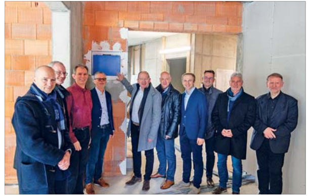
Beim Rundgang durch den Kita-Rohbau erläuterten die Bauverantwortlichen Oberbürgermeister Christian Specht, wo die Zeitkapsel eingemauert werden wird und was auf der Grundfläche des vor zwei Jahren abgerissenen Kindergartens Maria Hilf entstanden ist: Architekt Paul Heemskerck (v. l.), Rainer Boll, Winfried Glocker, Martin Baumgart, Christian Specht, Stephan Kolb, Arian Slota, Hermann Sommer, Lothar Seidel und Martin Wetzel. Bild: kathma/Schuhmann
