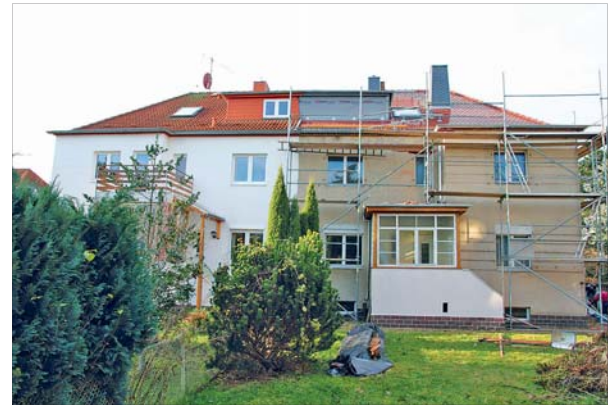
Laut einer aktuellen Verbraucherschutzstudie sind Baumängel auch in der Sanierung von Altbauten keine Seltenheit. Foto: djd/Bauherren-Schutzbund/Joachim Rosse
