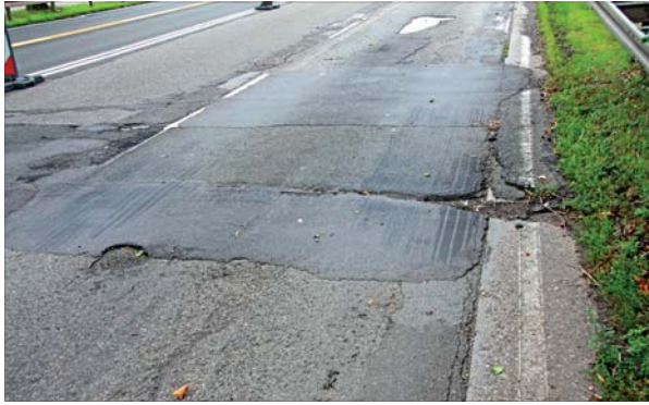
Einige der schadhaften Stellen der B 44 kurz nach der Sperrung im August 2023.
