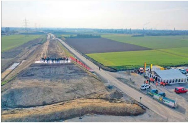
In diesem Jahr sollen die sechs Pfeiler für die neue Neckarbrücke errichtet werden.
