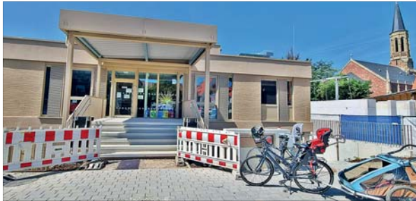
Zwei Jahre lang wurde das ehemalige Gemeindehaus der Erlösergemeinde umgebaut. Foto: de Vos
